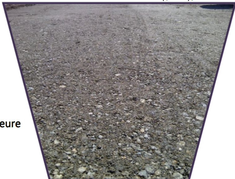
Voie PL sur la centrale AMR (77196).
